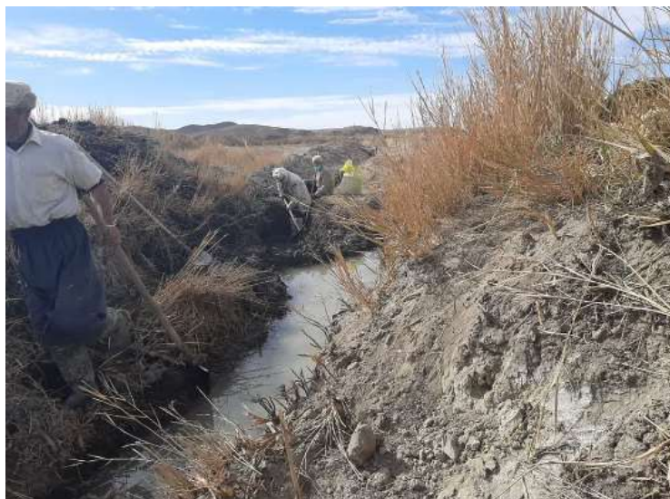
تصویر شماره ۱۵: همکاری مالکین در پروژه احیا و مرمت قنات شورود وسط
